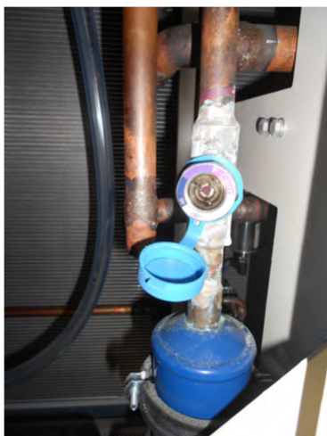
Abbildung: Schauglas für Kältestrom
