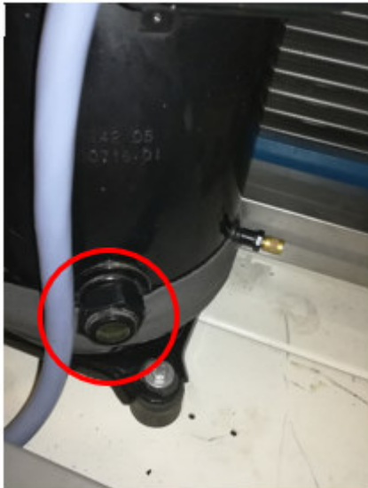
Abbildung: Schauglas für Ölstand im Kompressor
