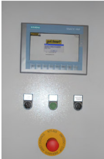
Abbildung: Bedieneinheiten Schaltschranktür
