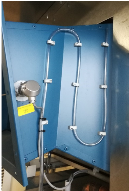
Abbildung: Messung des Gesamtgegendruckes
