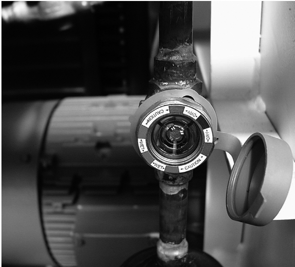
Abbildung 5-11: Schauglas für Kältestrom
