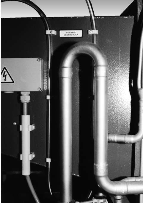
Abbildung 5-15: Messung des Gesamtgegendruckes
