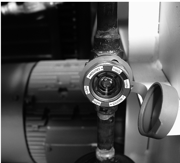
Abbildung 5-3: Schauglas für Kältestrom
