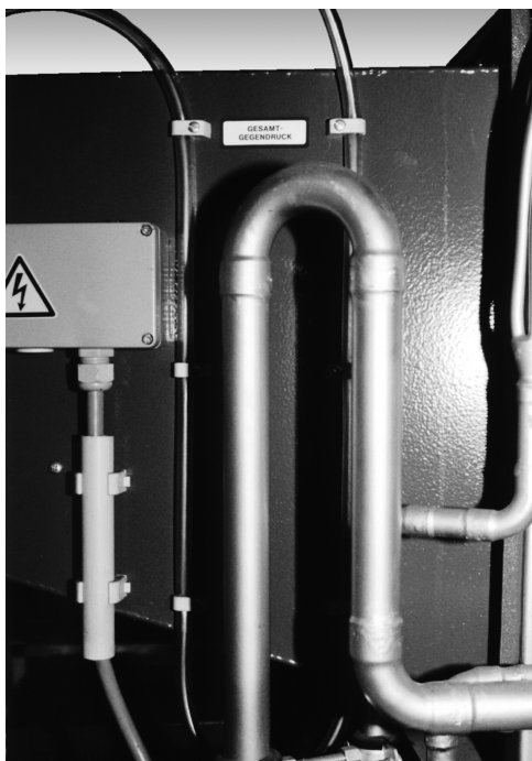
Abbildung 5-7: Messung des Gesamtgegendruckes
