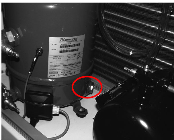
Abbildung 5-4: Schauglas für Ölstand im Kompressor
